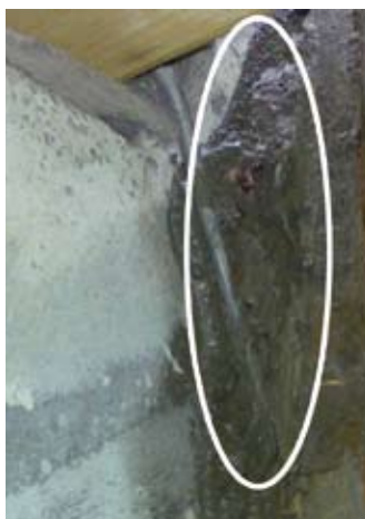
Gjutspill kortsluter elastiskt upplagd trappa mot trapphusplan.
