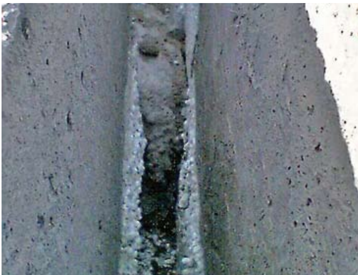
Gjutspill kortsluter mellan bottenplattor.
